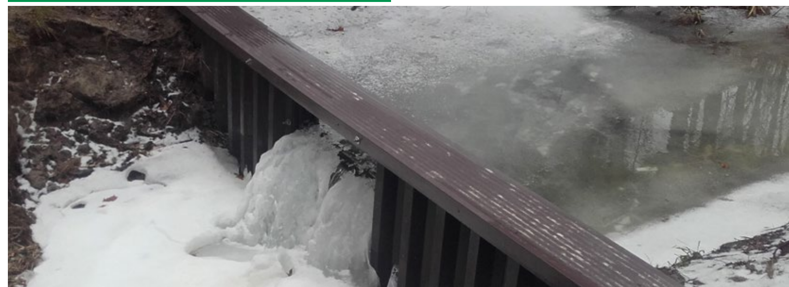
WOJ. WIELKOPOLSKIE, POLSKA: ZASTAWKI WYKONANE Z PVC SĄ TRWAŁE I ODPORNE NA WARUNKI ATMOSFERYCZNE.
