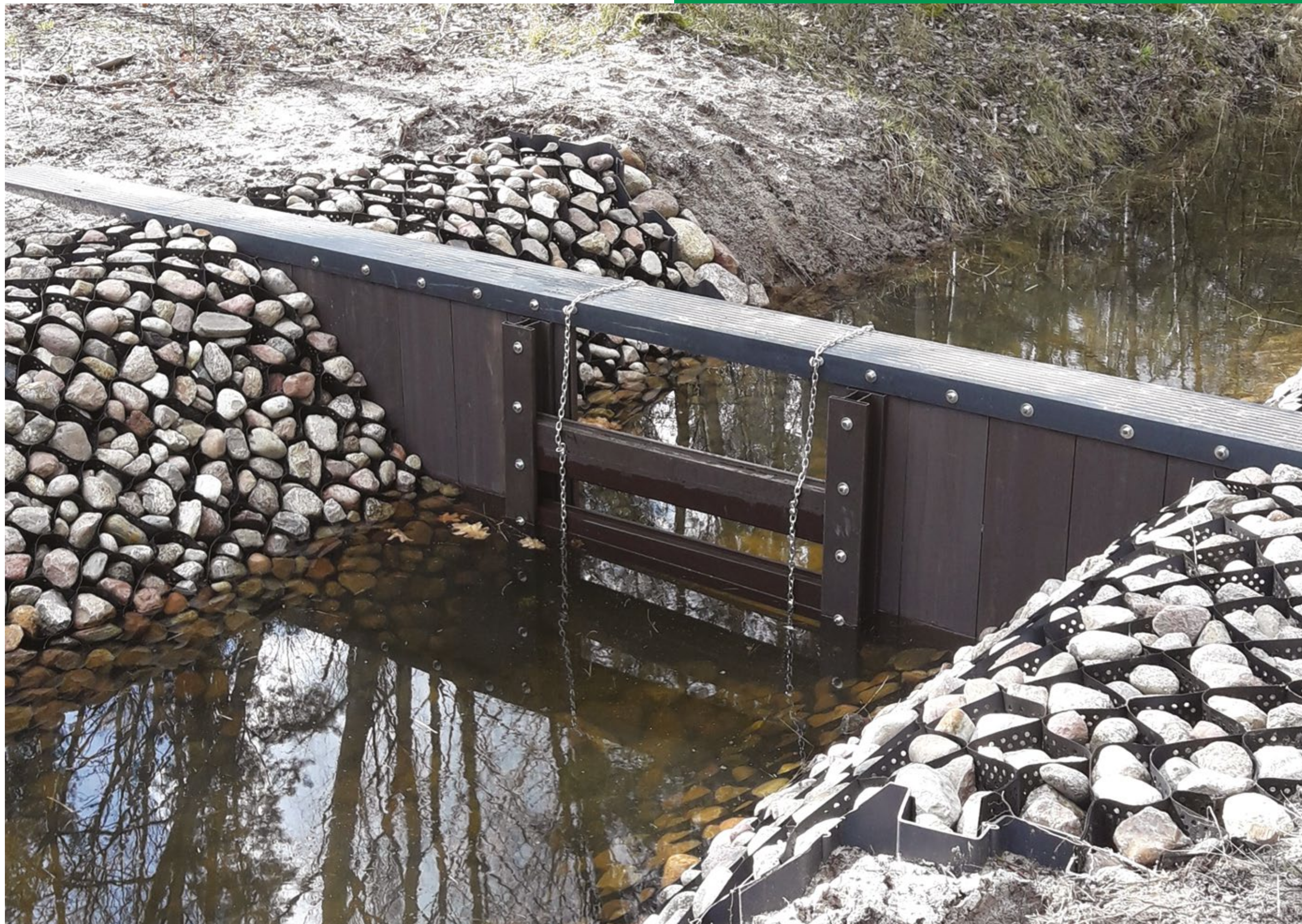
GRABÓW, POLSKA: JEDEN Z ELEMENTÓW KOMPLEKSOWEGO SYSTEMU RETENCJI KORYTOWEJ W DORZECZU PILICY.
