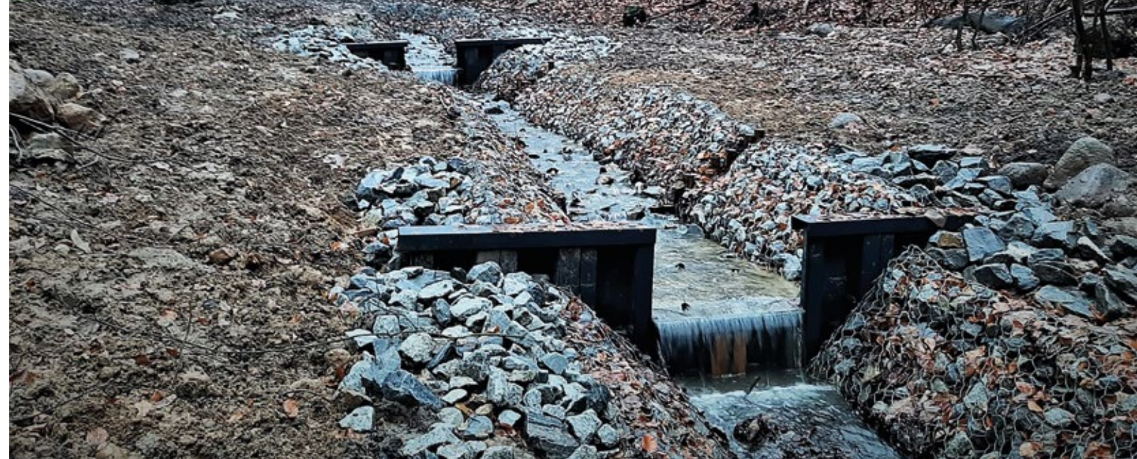
SZCZECIN, POLSKA: SYSTEM PROGÓW WODNYCH WYKONANYCH Z GRODZIC WINYLOWYCH WYKOŃCZONYCH OCZEPEM.
