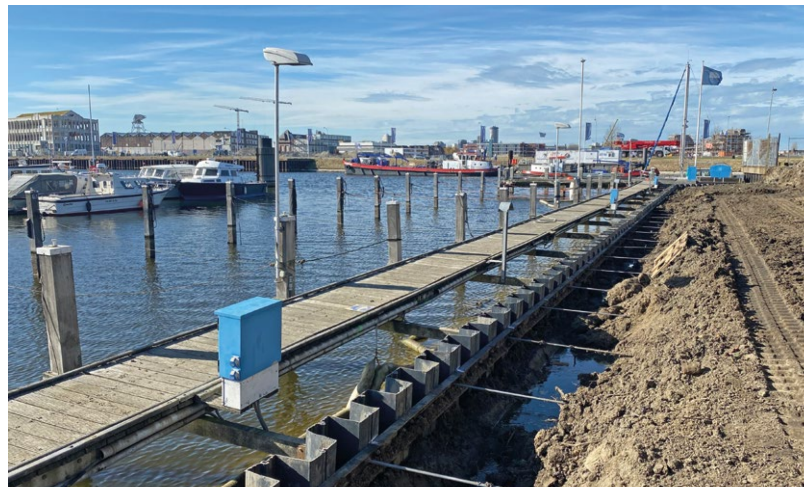
VLISSINGEN, HOLANDIA: KONSTRUKCJA Z GRODZIC WINYLOWYCH WZMOCNIONA SYSTEMEM KOTEW W PROJEKCIE MODERNIZACJI PORTU.
