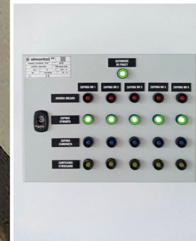
TABLICA KONTROLNA W POMIĘSZCZENIU BMS W STANIE GOTOWOŚCI ZAPÓR
