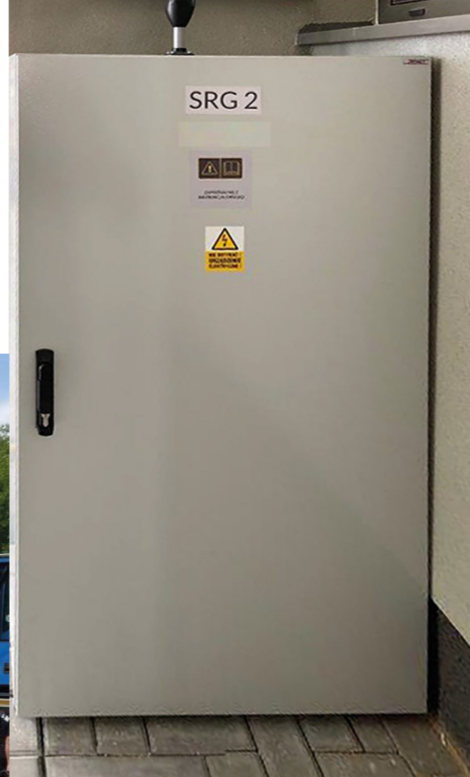
SZAFKA GŁÓWNA SRG Z WIDOCZNĄ OSŁONĄ PRZEWODÓW ŁĄCZĄCYCH Z BUDYNKIEM
