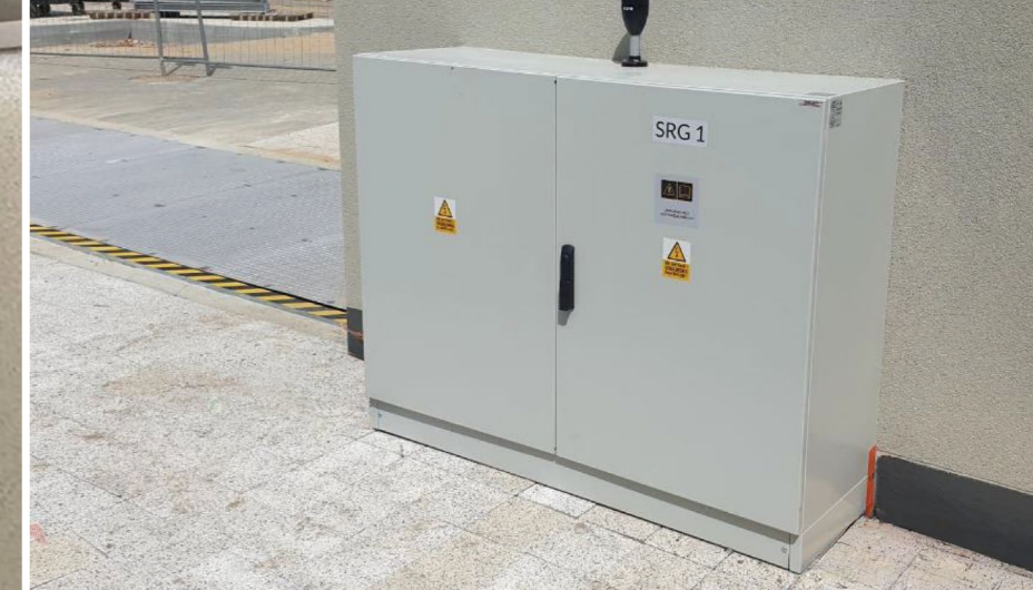
SZAFKA STALOWA Z AGREGATEM I SZAFĄ STEROWNICZĄ
